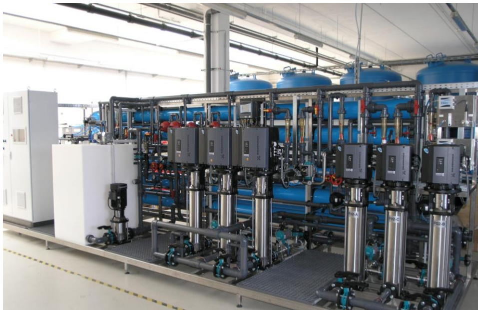
Рис. 1. Оборудование станции водоподготовки
