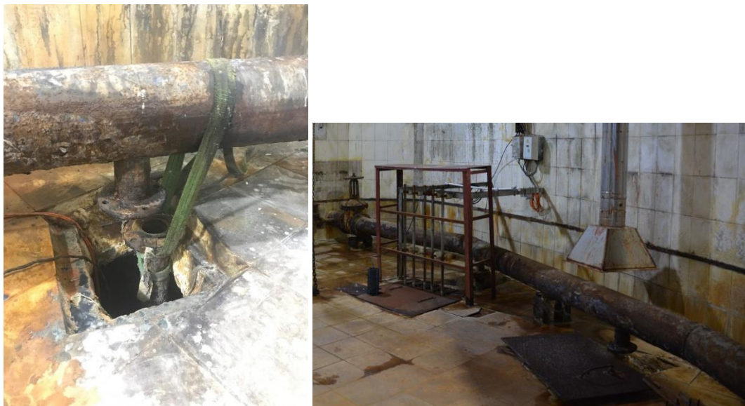
Рис. 6,7. Пример необходимости реконструкции вспомогательных систем КНС. Система взмучивания.
