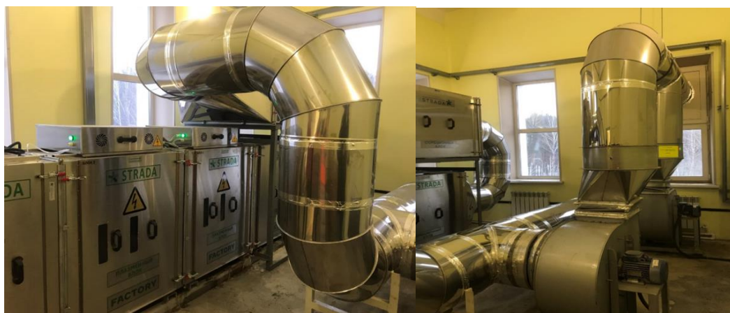
Рис. 5. Пример установки газоочистного оборудования при реконструкции вспомогательных систем КНС
