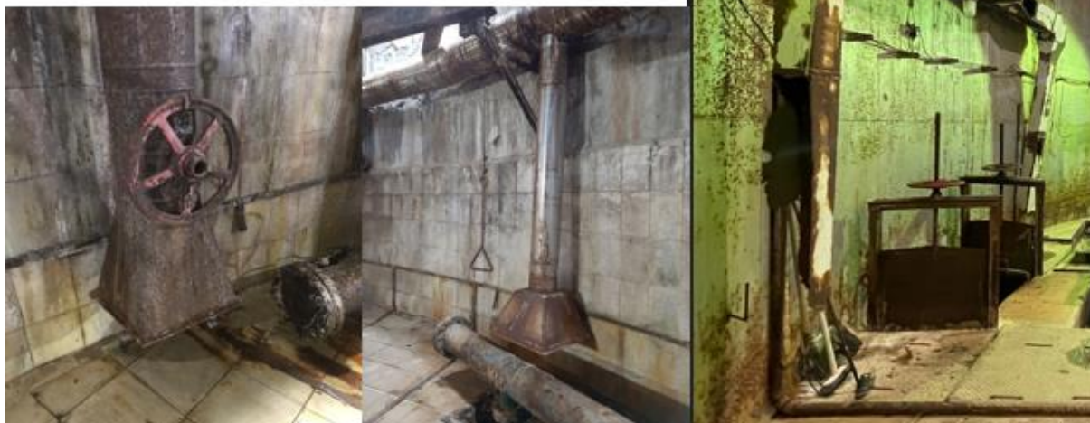
Рис. 4. Пример необходимости реконструкции вспомогательных систем КНС. Система вентиляции
